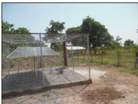
Impianto fotovoltaico energia solo alle pompe
