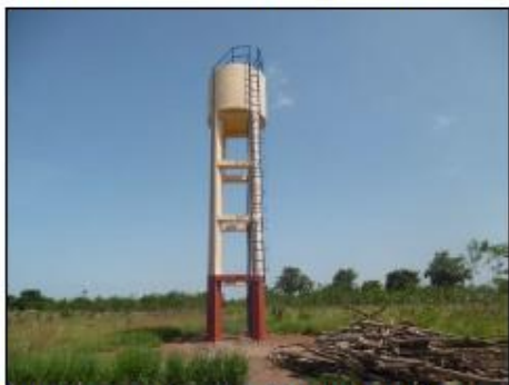
Torre piezometrica con serbatoio di raccolta acqua
